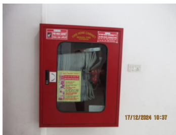
Fire hose cabinet.JPG
