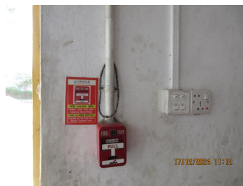
Fire alarm switch.JPG
