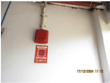
Visual Fire Alarm.JPG
